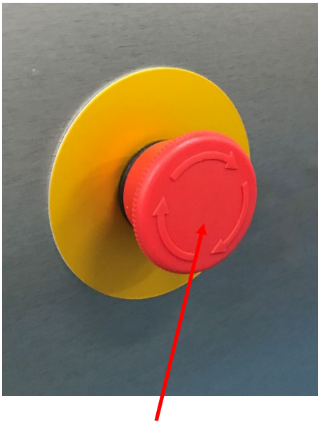
Vérifier le bon fonctionnement de l'arrêt d'urgence
